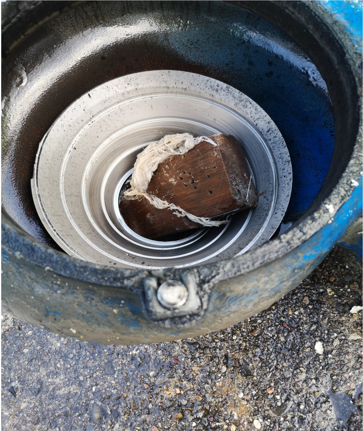
Holz Keil verstopft eine Abwasserpumpe
