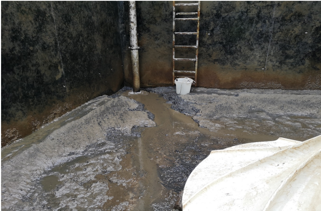
Ablagerungen im Denitrifikationsbecken
